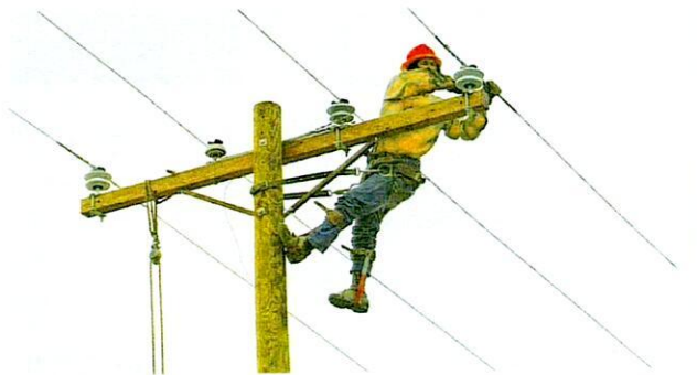
Hình 79: Nguy cơ tai nạn điện giật
